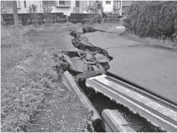
図2 道路に生じた大きな亀裂：阿蘇 (4月28日 中村透撮影)
